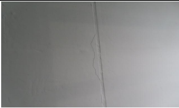
밸브검수실 내부 벽체 신축이음부 균열(0.3mm미만)
