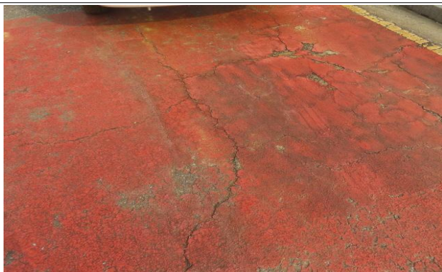
포장부 아스콘 망상균열
