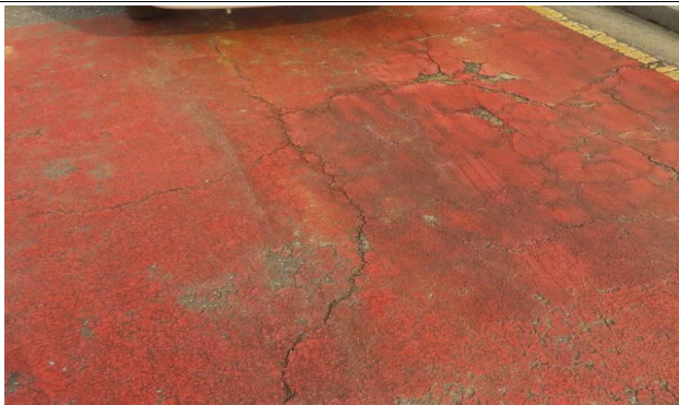
포장부 아스콘 망상균열
