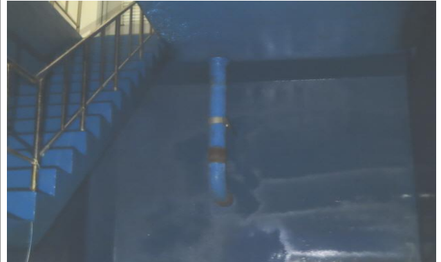
배수지 1지 오버플로우 배관 부식
