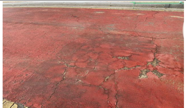
포장부 아스콘 망상균열
