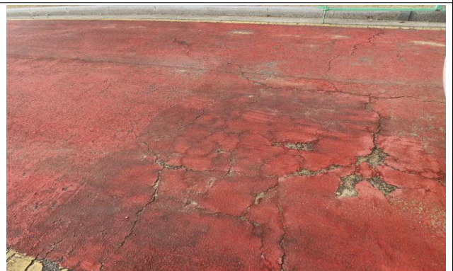
포장부 아스콘 망상균열
