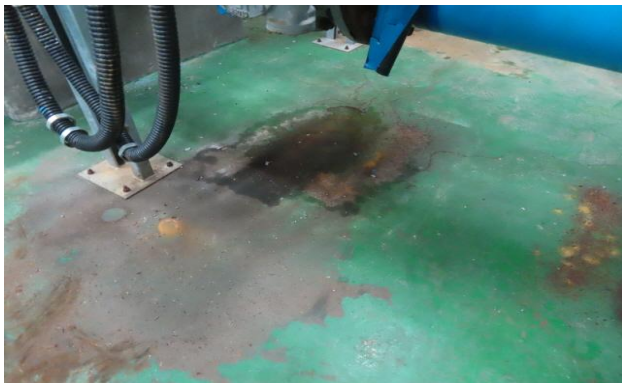
유입밸브실 바닥슬래브 체수흔적
