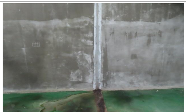
유입밸브실 벽체 누수흔적
