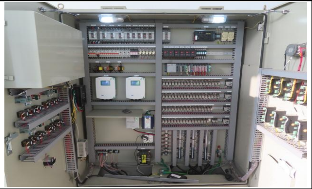
전기실 TM/TC 제어반 상태양호
