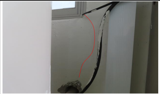
전기실 벽체 균열(0.3mm미만)
