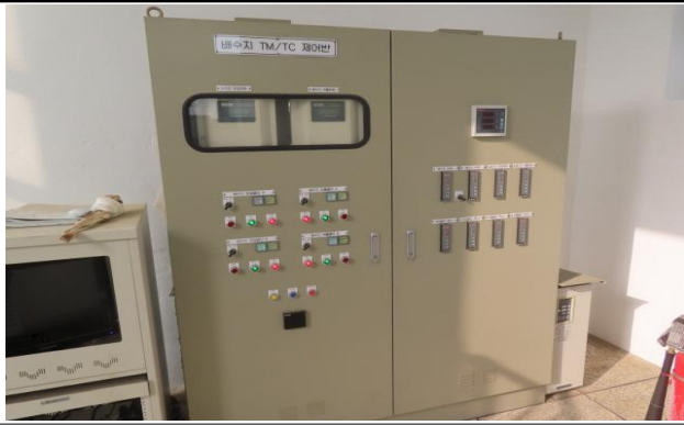
전기실 TM/TC 제어반 상태양호
